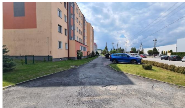
Spękana nawierzchnia drogi wewnętrznej
