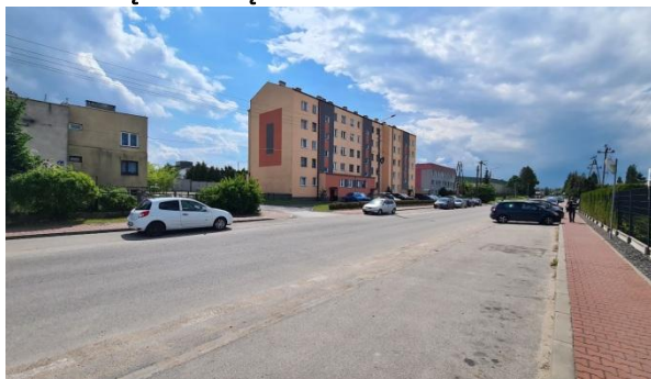
Stan nawierzchni ulicy Przemysłowej, widok na zabudowę blokową
