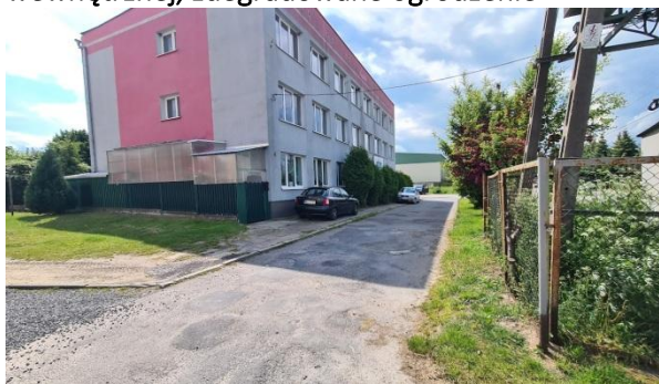
Przykład zniszczonej, spękanej nawierzchni drogi wewnętrznej, zdegradowane ogrodzenie
