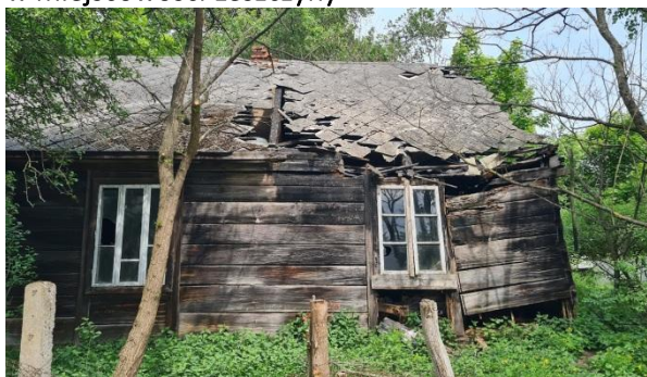
Przykład zdegradowanego drewnianego budynku w miejscowości Leszczyny
